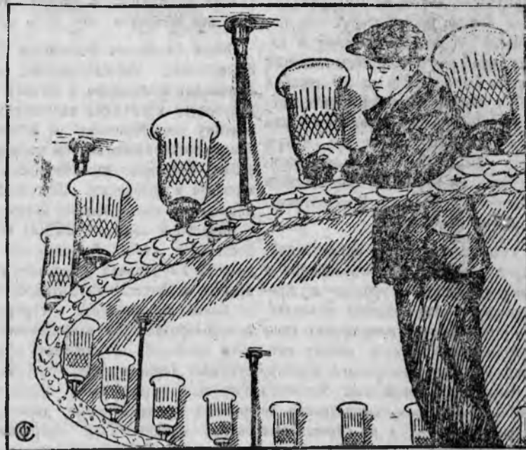
Монтаж люстры в кассовом зале станции „Курская“. Работает электромонтажник т. В. С. Домогацкий.
